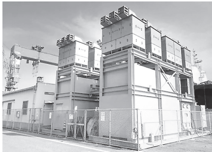
陸上電力供給設備
