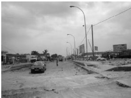
劣化が激しい幹線道路 (ルアンダ)
