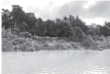
写真2 川岸の崩壊状況 (ほぼ直立に崩壊している)
