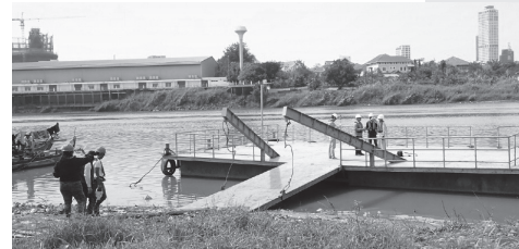
写真5 水上タクシー用浮体式係船岸 (雨季には陸側に移動する)
