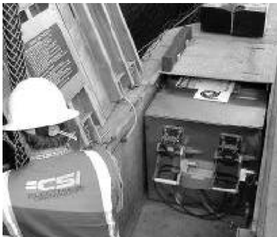
陸上電源設備 (AMP) 陸側設備
