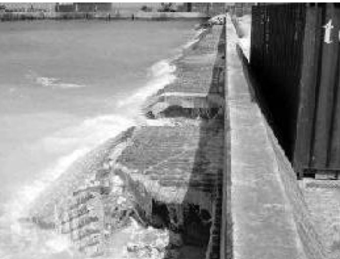
写真1 異常波浪により被災した護岸
